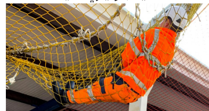
شکل ۲- (تورهای نجات نصب شده طبقات)
