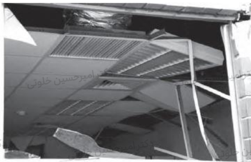
جدا شدن درپچه پخش هوا از سقف در اثر زلزله
